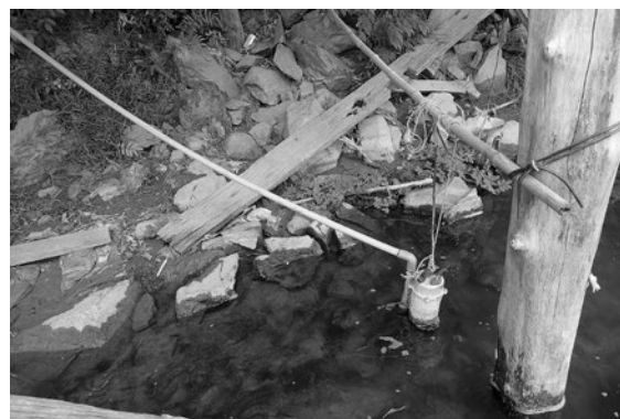
写真8 メコン川に設置された家庭用ポンプ
