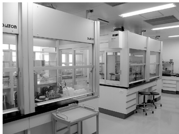
写真7 理化学エリアに設置されているドラフト群
