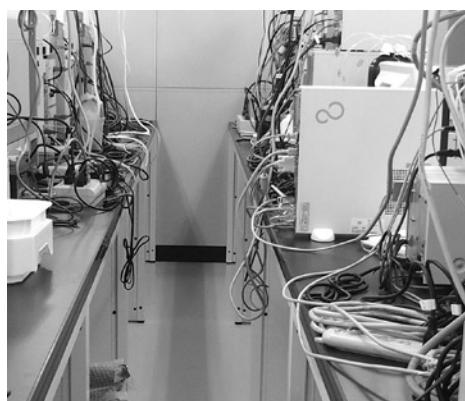
写真6 機器の裏はメンテナンス用に人が通れるようになっている
