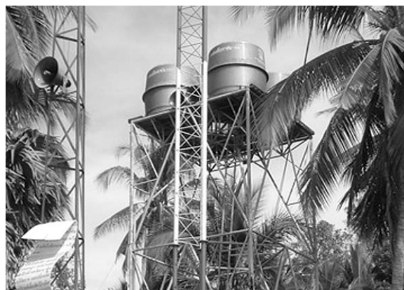
(b) 集落水道における配水タンク (タイ・コンケン市)
