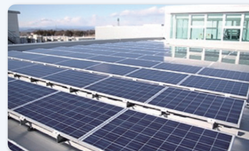
太陽光パネル
