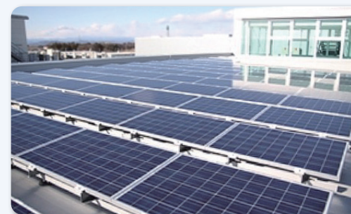
太陽光パネル
