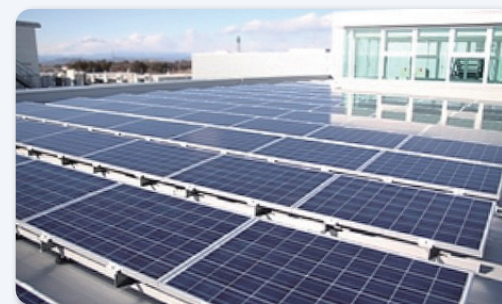
太陽光パネル
